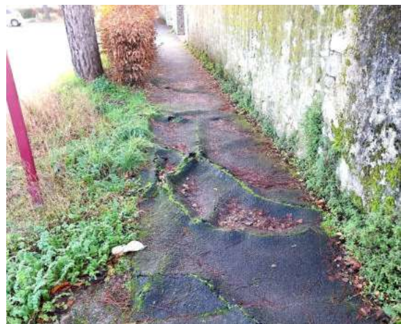
Déformation du cheminement, frein à l'accessibilité
