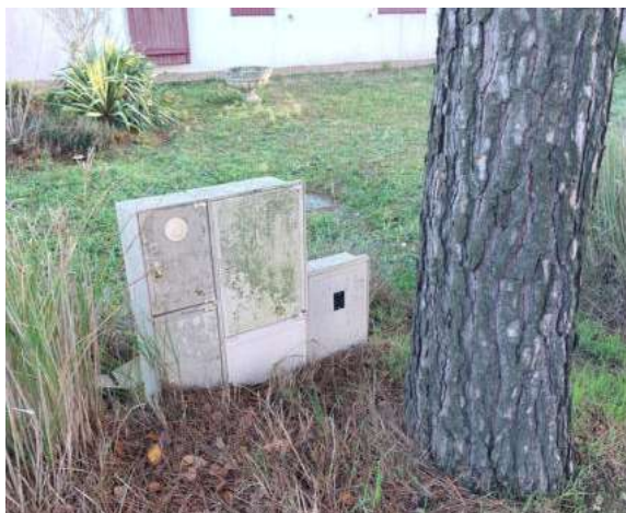
Proximité des réseaux
