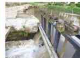
Vanne d'alimentation du coursier de fuite
