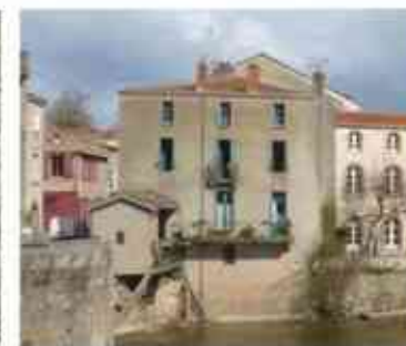
perte des encadrements de baies
