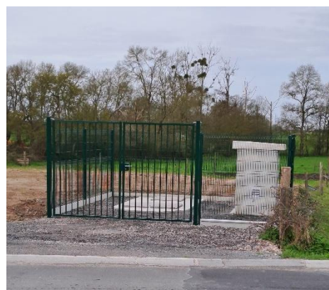
Nouveau poste de relevage à La Gausserie – La Planche
