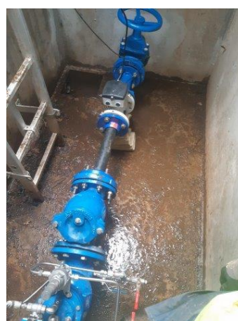
Compteur d'achat d'eau sur le réseau de transport avec débitmètre à Gorges
