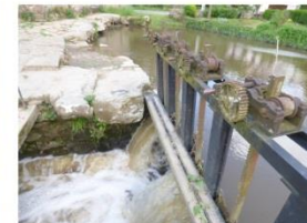
Vanne d'alimentation du coursier
