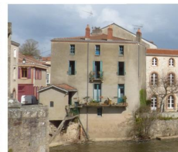
perte des encadrements de baies
